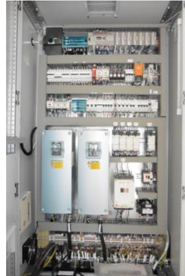
Armoire de commande
