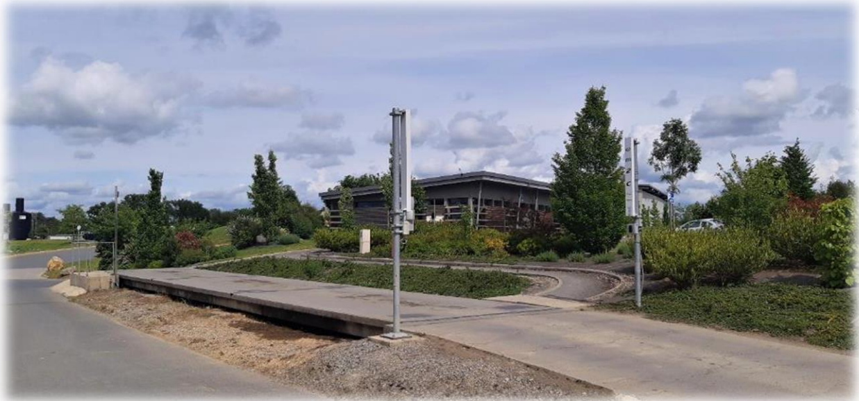
Portique de radiodétection à l'entrée du pont-bascule
